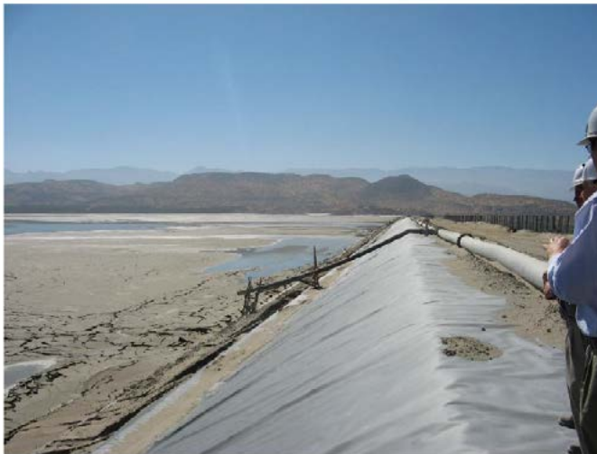
Figura 8. Vista del talud de aguas arriba del Muro del Tanque Ovejería. En la foto se observa que no existen daños en la geomembrana. GEER Association Report N°. GEER-022. Figure 8. View along the upstream face of the Ovejería tailings dam. There is no damage to the liner. GEER Association Report N°. GEER-022.
